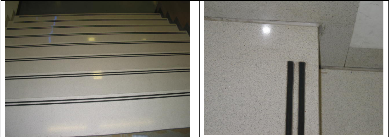
Abb. 7: Die ein bis zwei Millimeter erhabenen Gummilippen bilden einerseits eine (zwar geringe, aber doch vorhandene) Stolpergefahr. Hinzu kommt eine optische Irritation, da die kontrastreichen Streifen nicht genau die Kante anzeigen. Diese zwei Aspekte dürften der Grund dafür sein, dass sich auf Treppen mit dieser Struktur deutlich mehr Unfälle ereignen wie auf anders gestalteten Treppen. Dies ist seit 2000 bekannt [Fischer S. 23, Anm. 7]. Trotzdem wird diese Struktur weiterhin - insbesondere in öffentlichen Gebäuden - eingebaut (s. Abb. 18a, 21 und 23).
