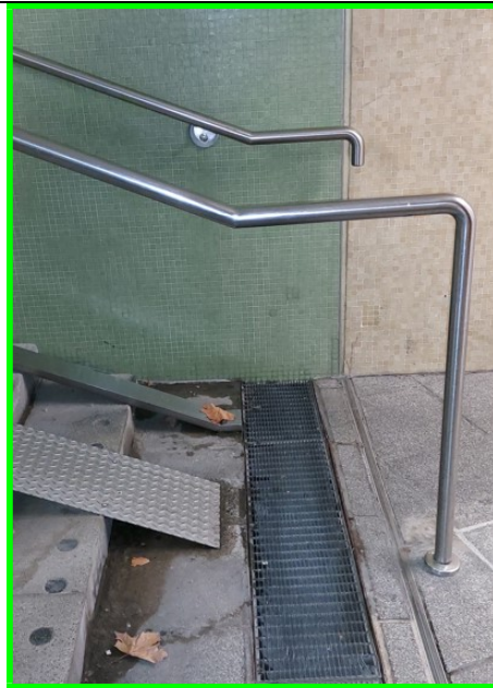
Abb. 12 Zwei Beispiele von optimal gestaltetem äußerem und innerem Handlauf: Treppenauge nicht unterbrochen, äußere Handläufe in 85 cm Höhe mindestens 30 cm waagrecht weitergeführt. Die Gestaltung der Stufenmarkierungen ist jedoch in beiden Fällen missglückt: Rippen bzw. Pastillen – siehe Abschnitt 2.2.5!)
