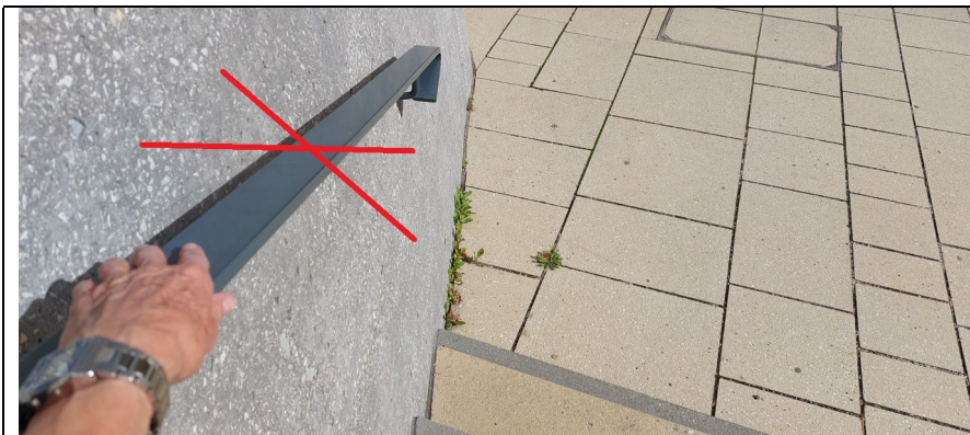
Abb. 9 Eine Hand greift auf einen gleichartigen Flachstahl-Handlauf wie Abb. 8. Dieser wurde ca. 2022 an einer viel begangenen Treppe im öffentlichen Freiraum eingebaut.
