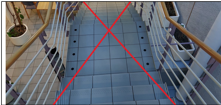
Abb. 18a) Surreale Innovation: Am Rand eines Treppenpodests wurden 2 x 4 schwarze Punkteingesetzt. Der Architekt war offensichtlich der Meinung, eine Markierung der Stufenkanten wäre damit überflüssig.
