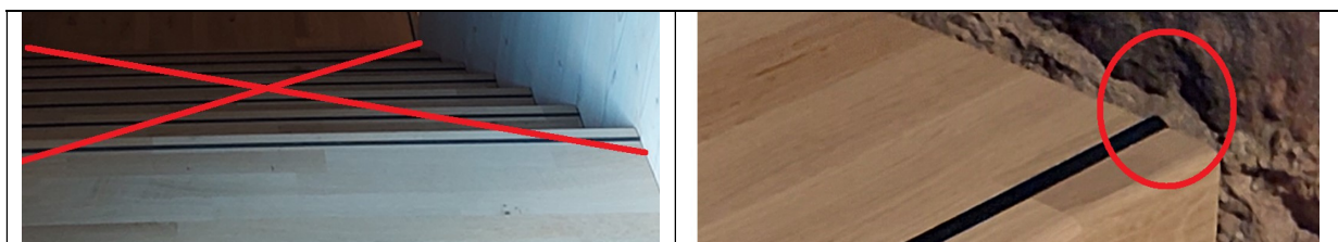
Abb. 21 Treppe eines öffentlichen Gebäudes, das 2024 eingeweiht wurde: a) Mit einer Gummiwulst wurde eine markante Linie ca. 5 cm hinter der Kante markiert. Dies kann gefährliche Irritationen ergeben, da man den Eindruck bekommen kann, die Stufe höre bereits hier auf (Siehe auch Abb. 10 b und 12a!). b) Der einige Millimeter hoch stehende Markierungsstreifen erhöht nochmals die Stolper- und Sturzgefahr.
